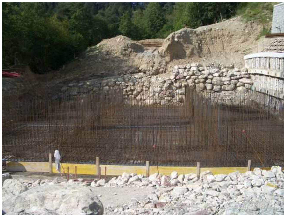
Foto 1: platea vasche denitrificazione ed ossidazione
